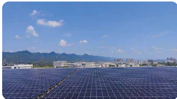
△京东方屋顶分布式光伏发电系统
